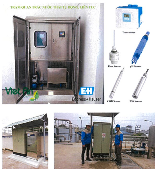
TRẠM QUAN TRẮC NƯỚC THẢI TỰ ĐỘNG
